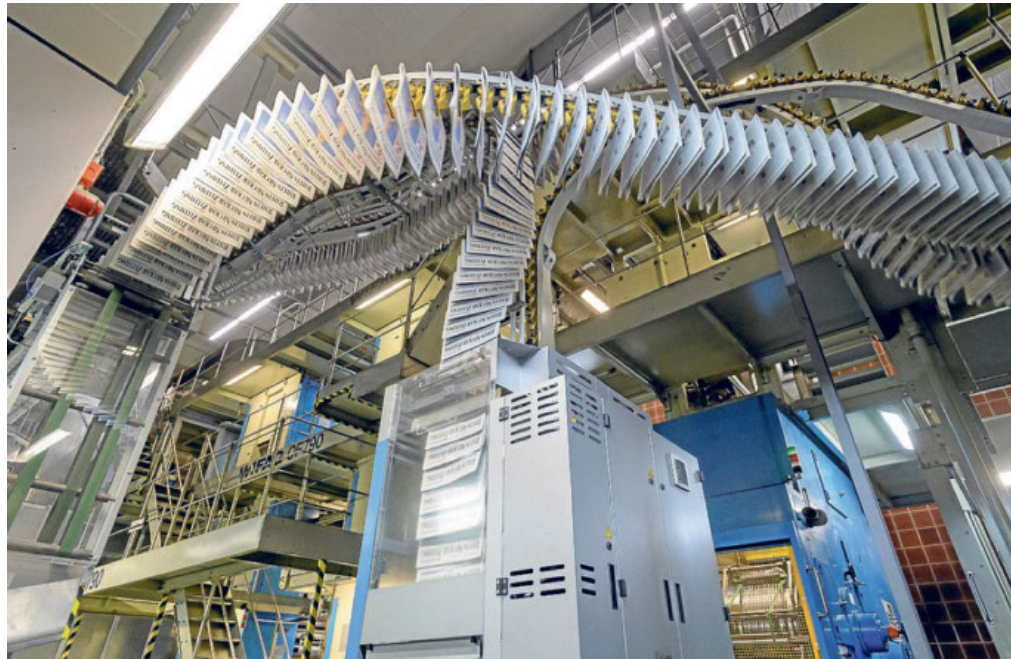
Ein Highlight im Druckzentrum ist das Zeitungsförderband, das fast durch das komplette Gebäude verläuft und die Ausgaben an den Bestimmungsort transportiert. Fotos: Philipp Rothe
